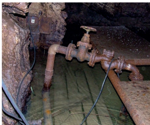
2. ábra: A barlangba a vízhasznosításhoz beépített csővezeték és járófelület egy részlete
